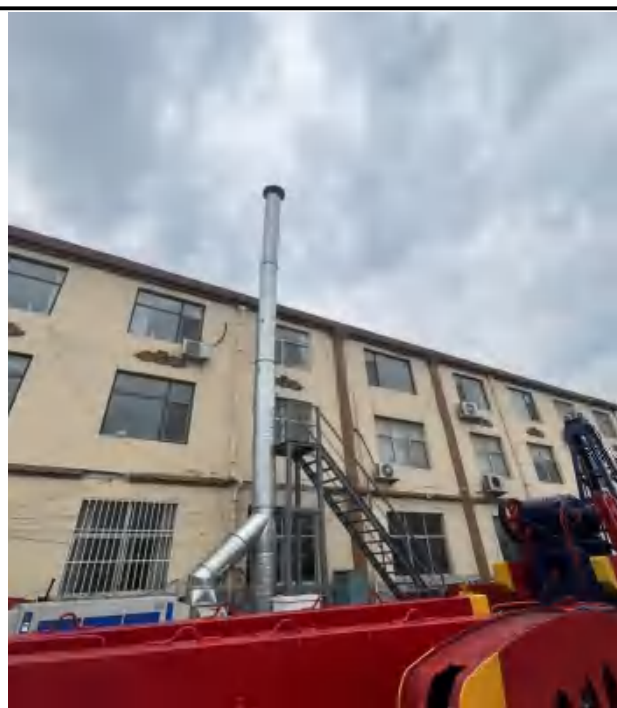
喷漆、晾干废气排气筒 DA001
