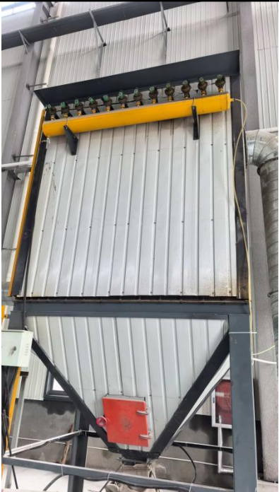
烘干废气排气筒 DA001 配套脉冲式布袋收尘器
