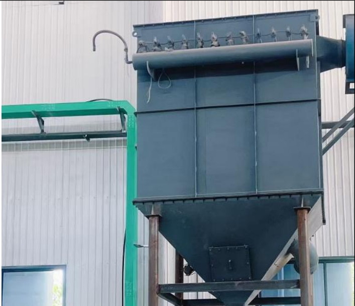
包装废气排气筒 DA003 配套脉冲式布袋收尘器（备用雷蒙磨粉机产生的磨粉废气）
