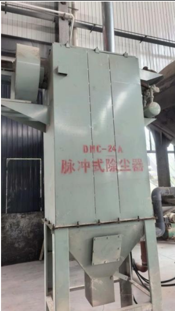
包装废气排气筒 DA003 配套脉冲式布袋收尘器（包装废气）
