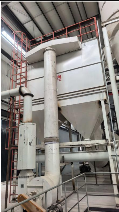
磨粉废气排气筒 DA002 配套脉冲式布袋收尘器
