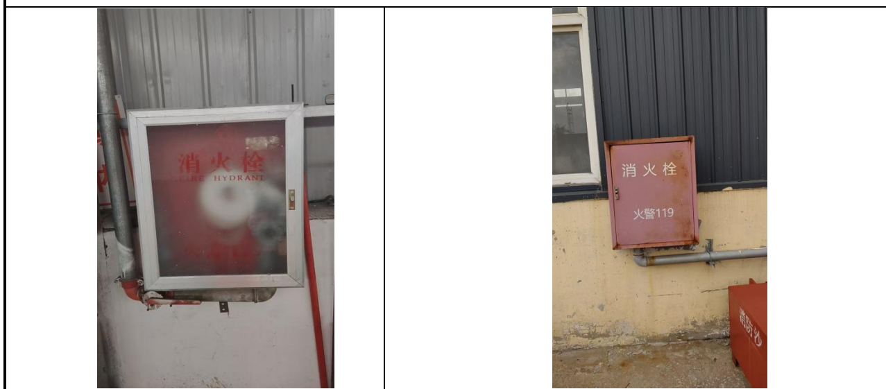
现场应急物资照片
