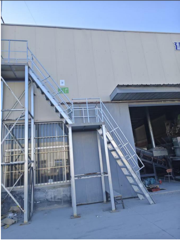
装修垃圾废气采样平台
