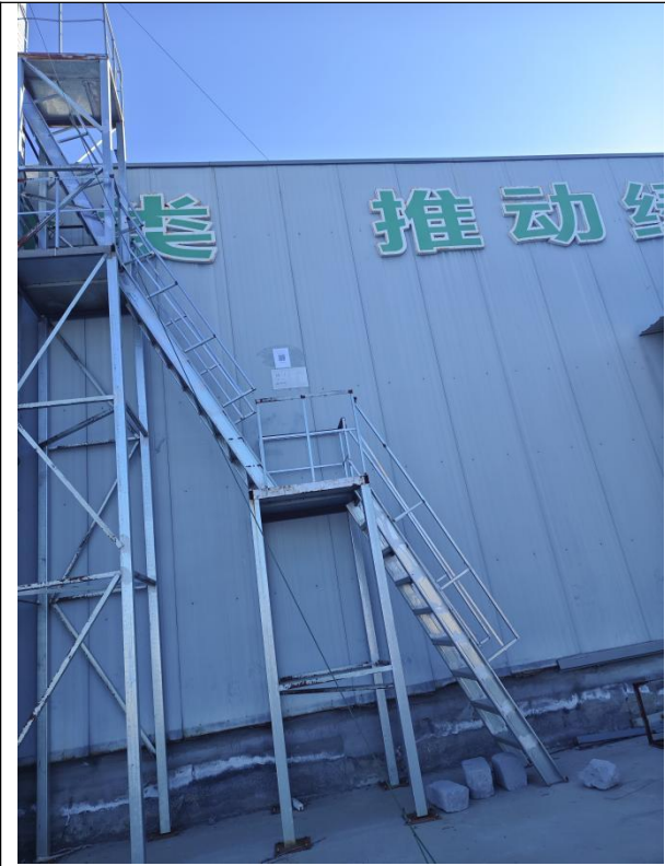
园林垃圾废气采样平台
