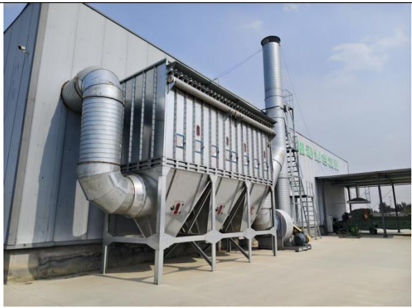
园林垃圾废气布袋除尘器+DA001 排气筒
