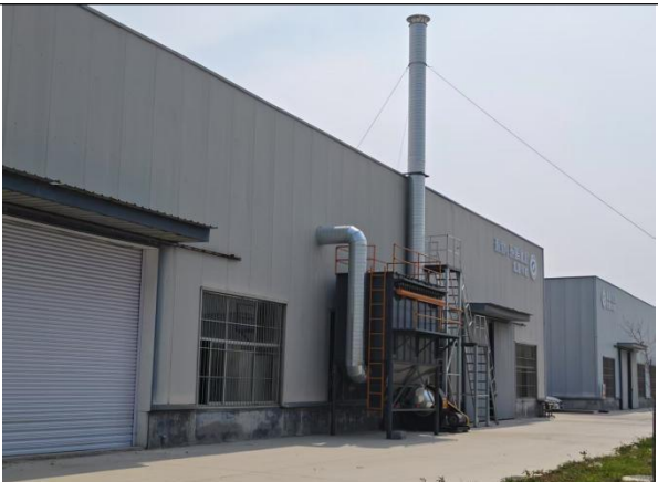
装修垃圾废气布袋除尘器+DA002 排气筒
