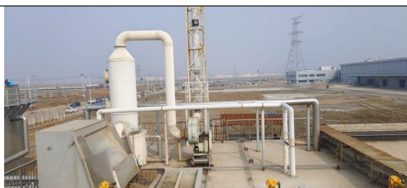
生物除臭装置
