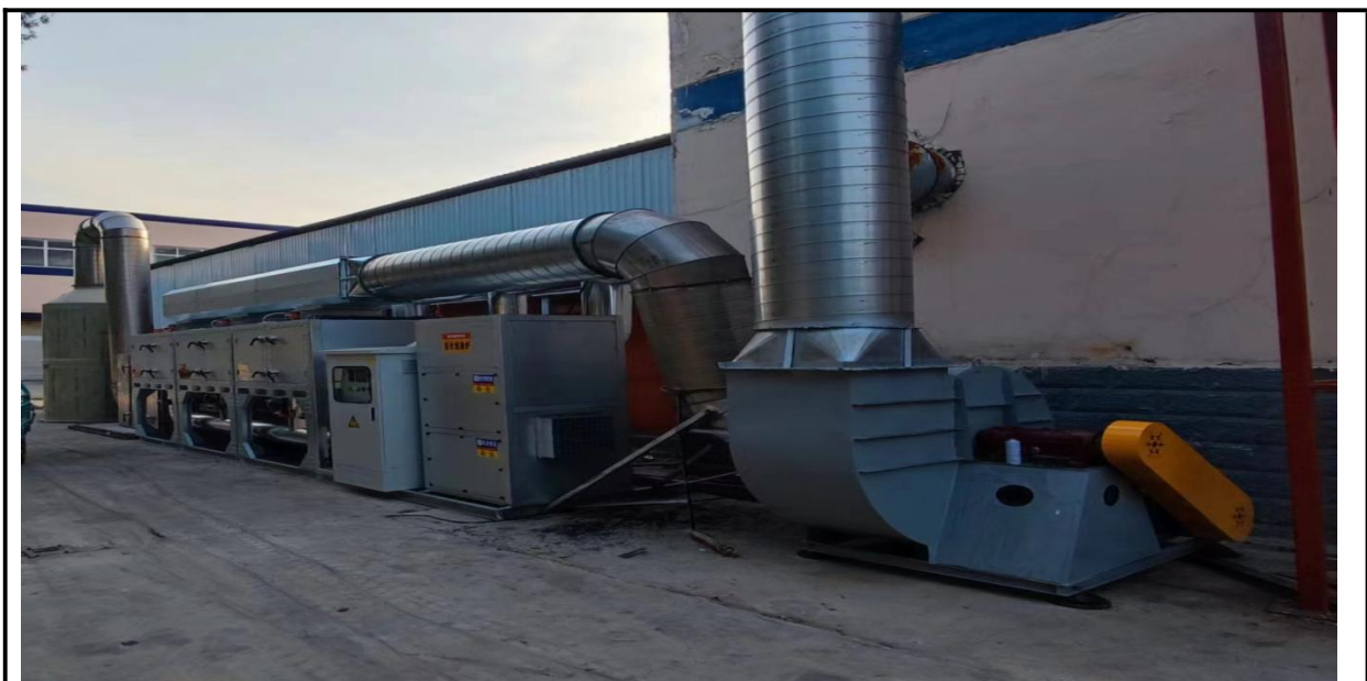
喷淋塔+干式过滤箱+活性炭吸附脱附催化燃烧
